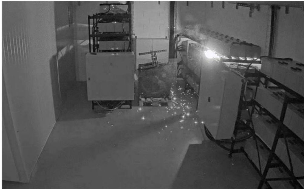
Photographie 6 : 0h35, départ de feu dans le local à batteries (source : image extraite de la vidéosurveillance OVH)
